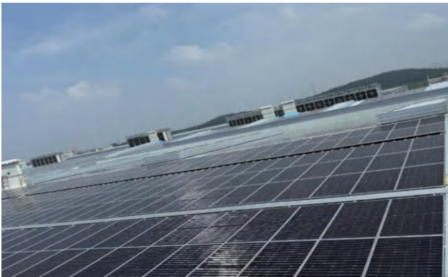
厂区屋顶光伏
